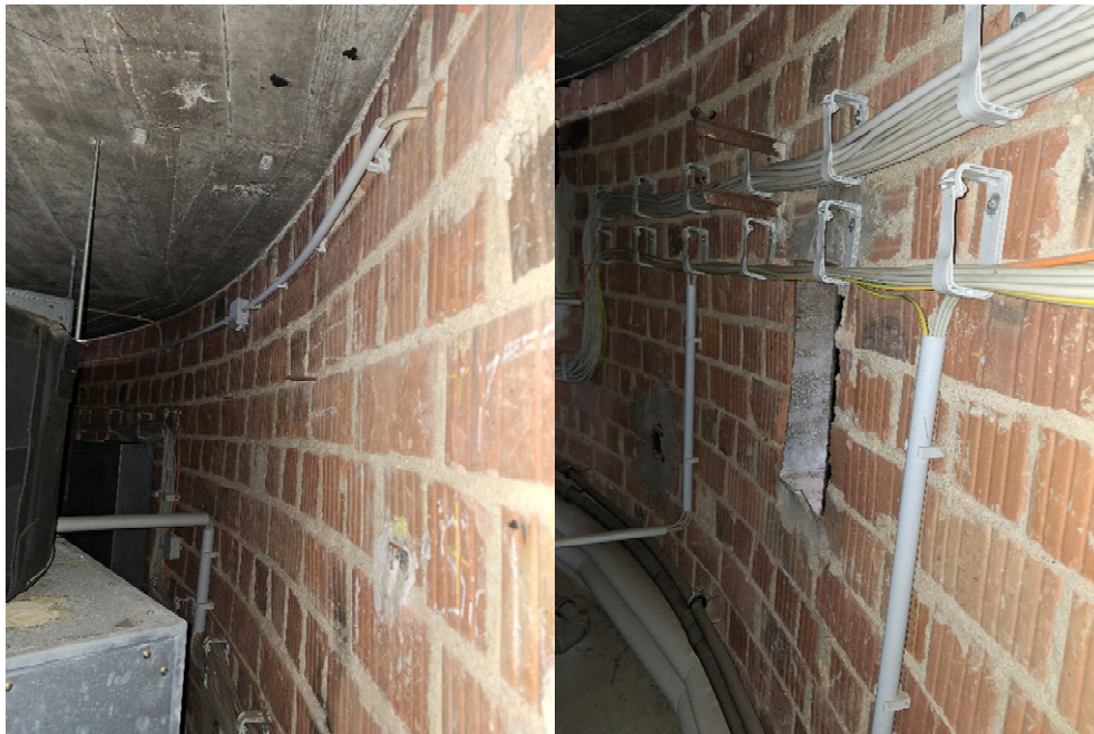
Abbildung 13: Abgedunkelte und verschlossene Belüftungsanlage. Rechstes Bild: Lüftungsschlitze, von außen jedoch durch Gitter verschlossen.
