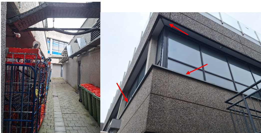
Abbildung 8: Betriebshof; linkes Bild: linker Gebäudeteil wird abgerissen; rechtes Bild. Durch Metallleiste verschlossenen Waschbetonfassade auf ca. 10m Länge. Spalte in Dachverkleidung
