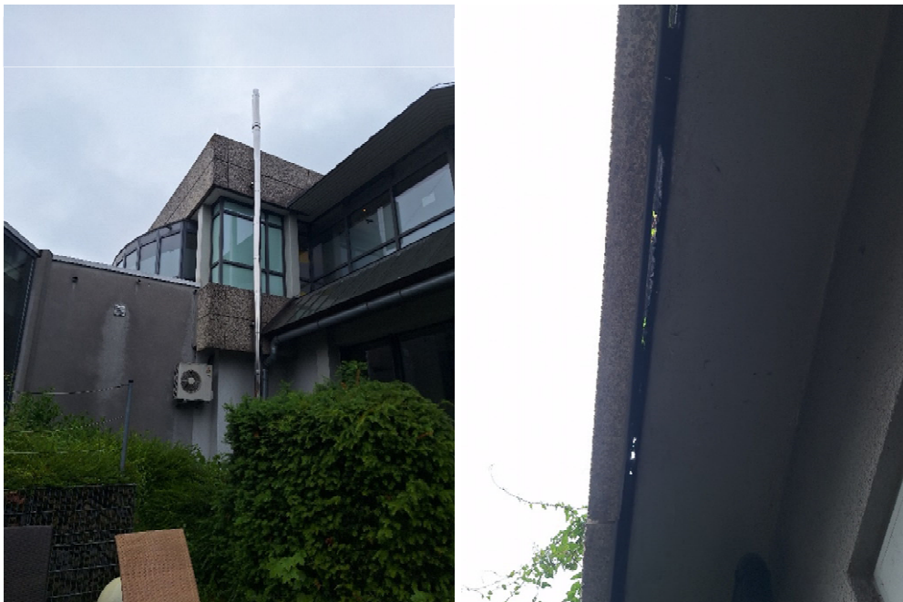
Abbildung 5: Grenze zwischen Abrissbereich und Bestandsgebäuden. Bild links: Der Abriss erfolgt an der Grenzlinie zwischen der hellgrauen und dunkelgrauen Fassade. Bild rechts: Waschbetonverkleidung, oben offen
