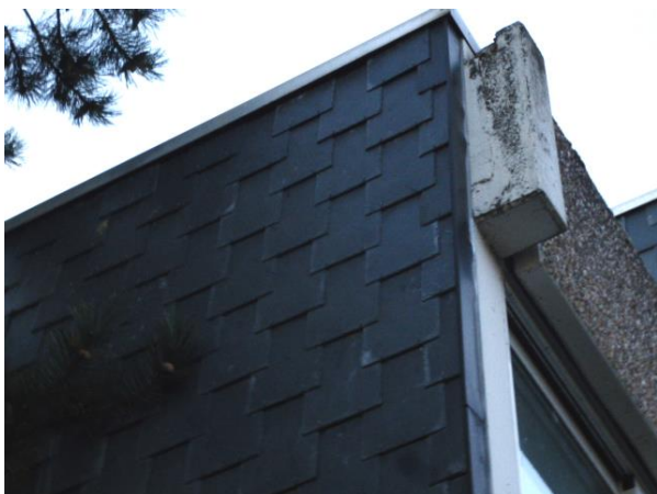
Abb. 4: Die Schieferverkleidung ist teilweise beschädigt und weist punktuell Lücken auf
